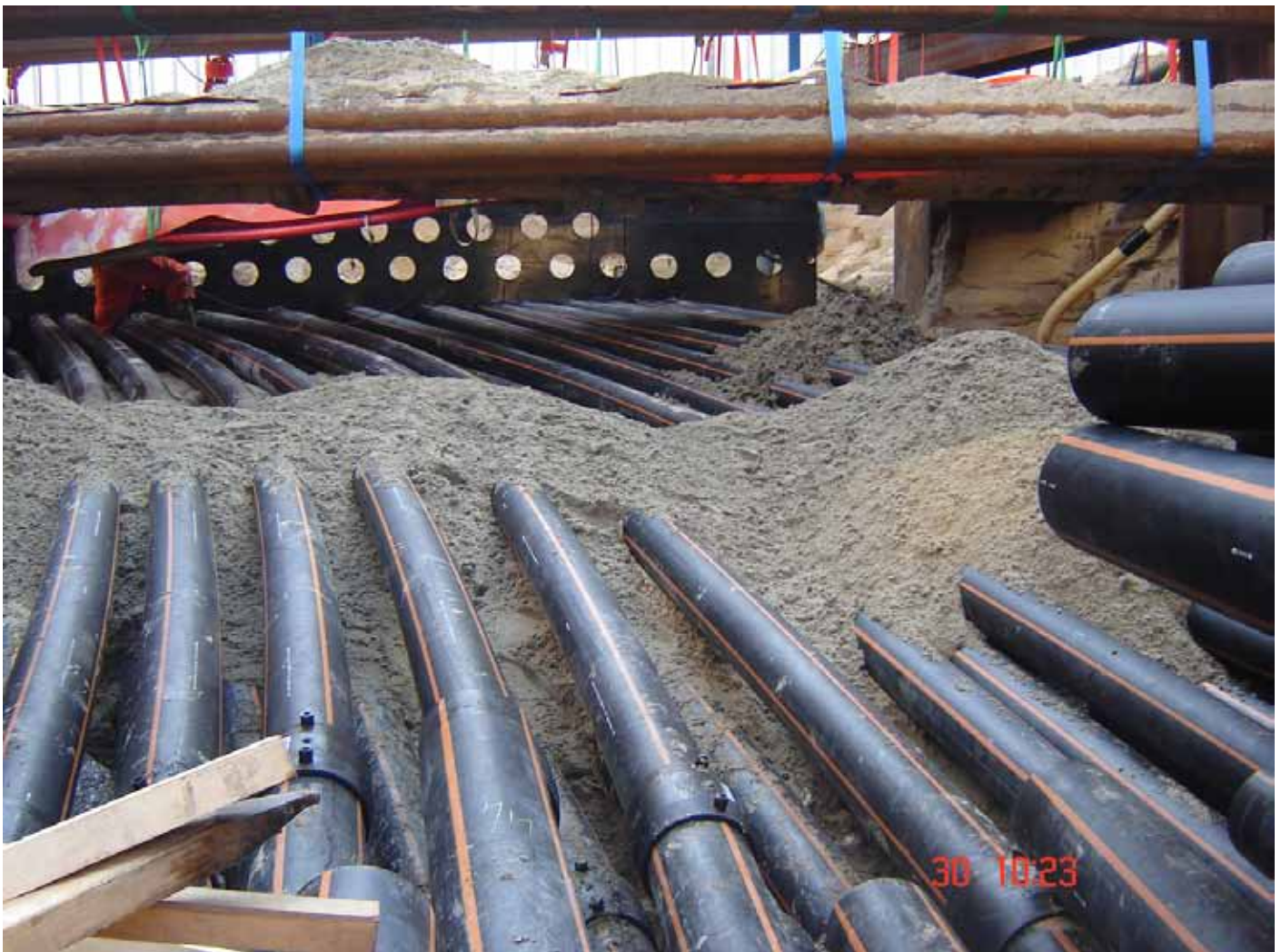
Aanleg van een bundeling van kabels en leidingen. Foto: dienst Zuidas Amsterdam.
