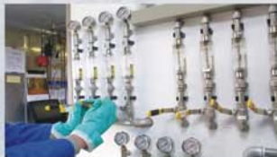
De bodemreinigingsinstallatie bestaat uit een procesunit en een opslagcontainer
