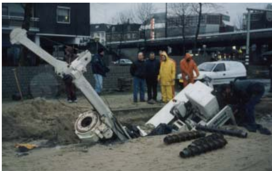
Fig. 3. Onvoldoende controle van diepten van leidingen bij gestuurd boren, waardoor een waterleiding is geraakt.
