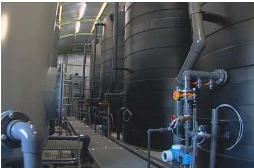
Foto 1. Anaërobe, dechlorerende bioreactoren op de locatie Evenblij, die worden gebruikt voor de in situ stimulatie van de biologische afbraakprocessen in de bodem door beënting van de bodem met dechlorerende biomassa.
